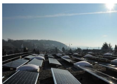
Solarprojekt Göttschihof (Kt. ZH) mit einer Solarmodulfläche von 300 m 2 ; 56 kWp Leistung und rund 63 MWh Stromproduktion.
